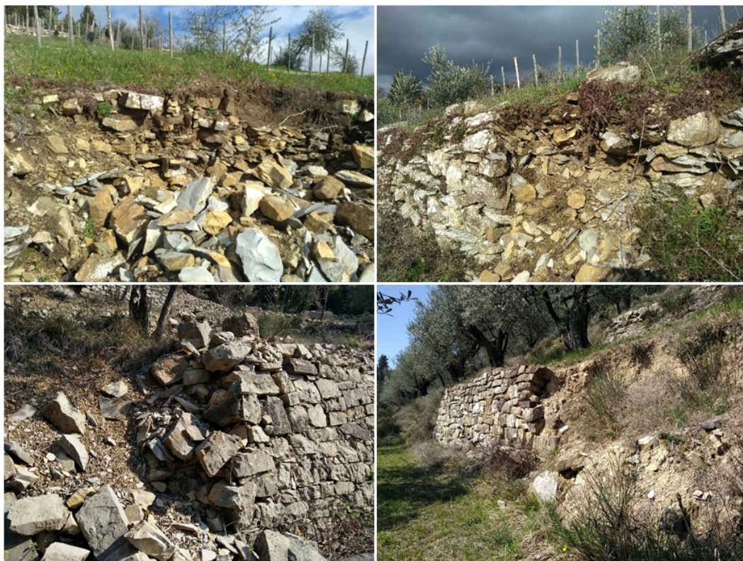
Figura 30: Esempi di crollo del paramento murario e del retrostante ripiano.
